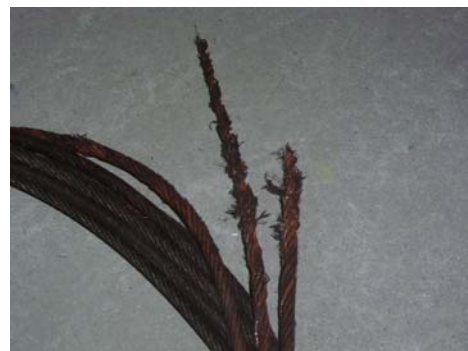
図3 ロープA、B破断部
